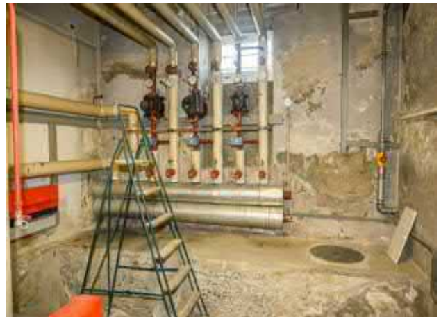
Hafenstr. 6: Impressionen Technik/Heizung
