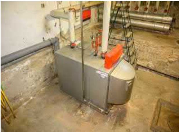
Hafenstr. 6: Impressionen Technik/Heizung
